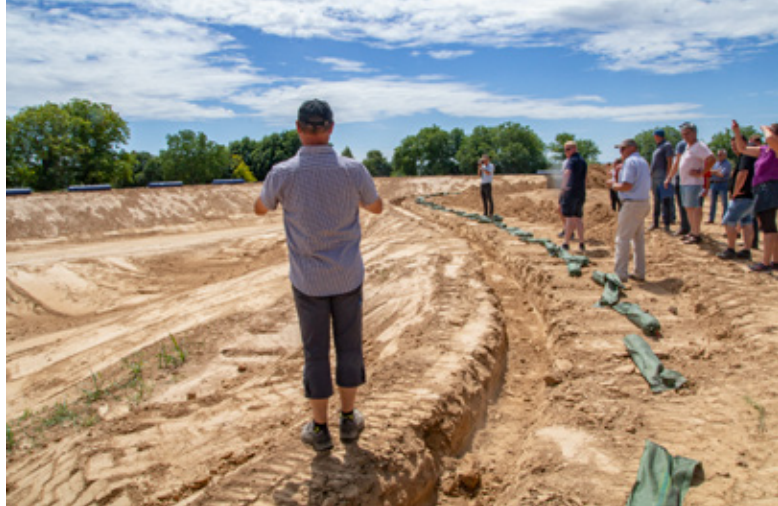
Das ist der neue Bewässerungsteich, der in Heuchlingen gerade gebaut wird. Die Wasserkapazität soll eine Frostschutzberegnung für vier bis fünf Nächte ermöglichen, während durch die großzügige Randzone ein wertvolles Biotop für zahlreiche Tier- und Pflanzenarten entsteht.
